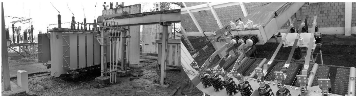
SLIKA 7 – NOVI ENERGETSKI TRANSFORMATOR
